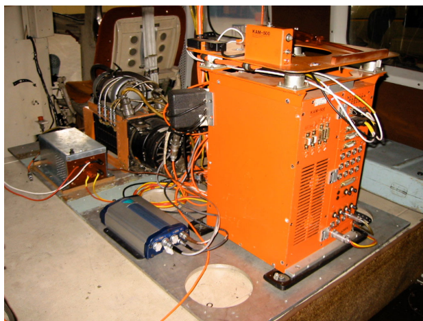
Rys.7. Urządzenie rejestrujące i odbiornik GPS zamocowane wewnątrz kadłuba
