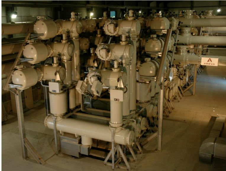
Rys. 3. – rozdzielnica 400 kV T-155-2 firmy Areva w stacji Amorebieta
