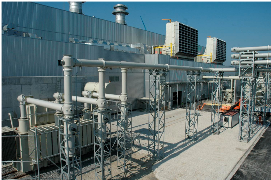
Rys. 4. – Połączenia gazowe rozdzielnicy 400 kV T-155-2 firmy Areva z transformatorami blokowymi elektrowni w stacji Amorebieta.
