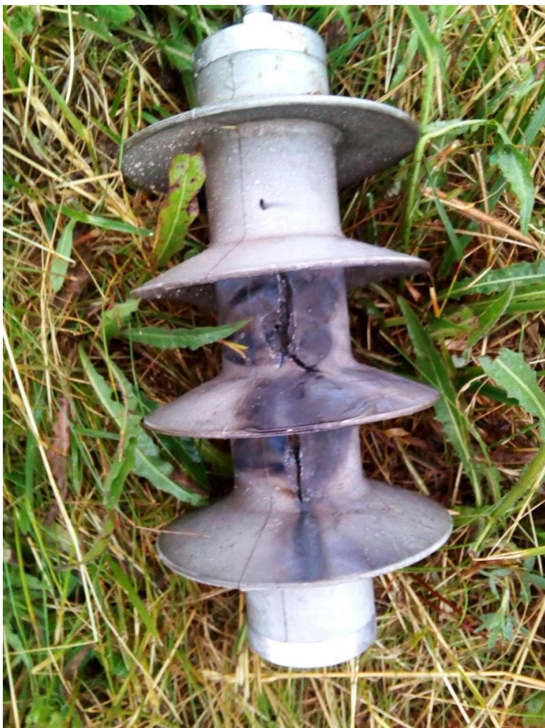
Rys. 4.15. Uszkodzony po burzy ograniczniki przepięć SN.
